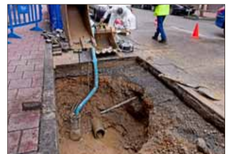
La fuga de una tubería ayer en Valladolid. P. REQUEJO
